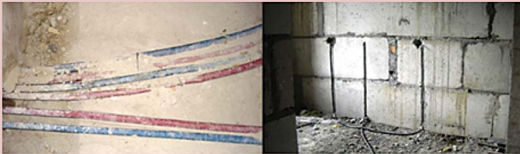
Рисунок 7. Мусор на площадке во время строительства
