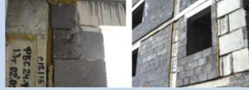
Рисунок 6. Неточное соединение строительных элементов
