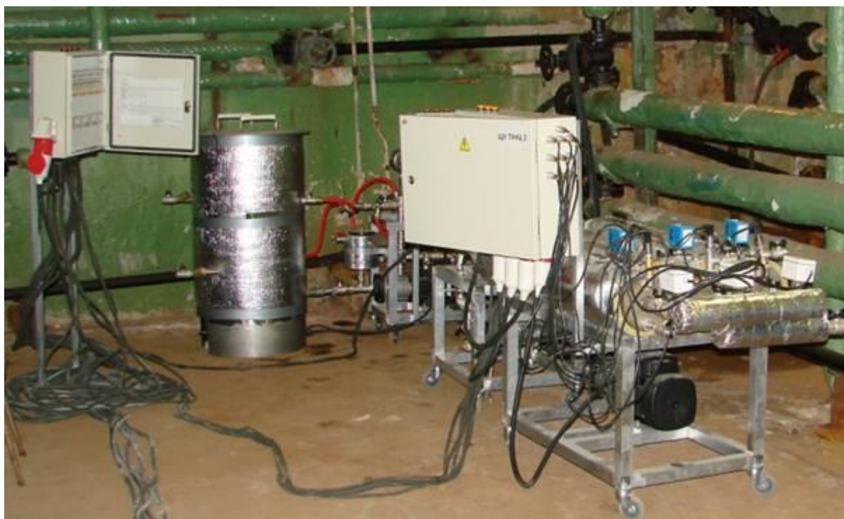
Рис. 3. Общий вид мобильной установки.
