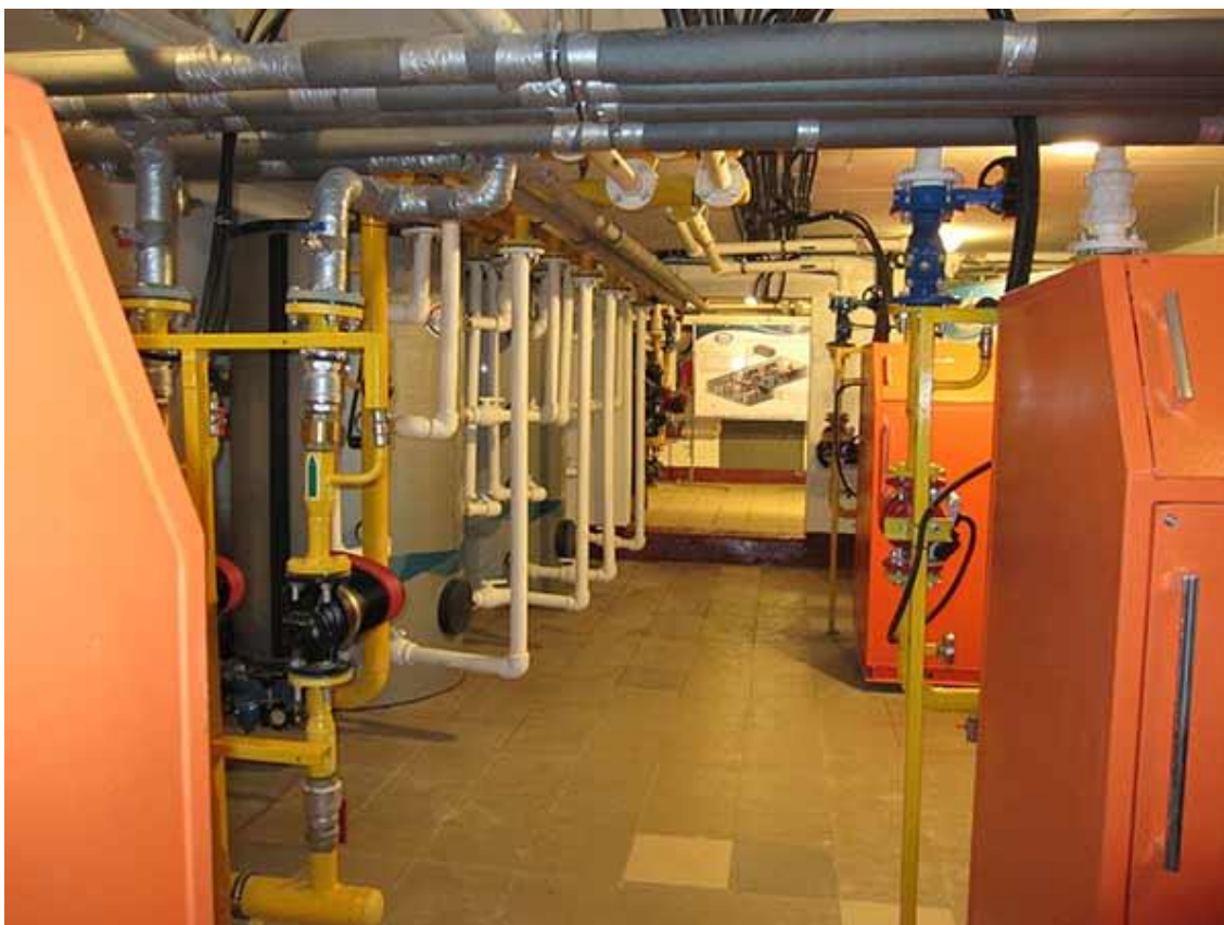
Рис. 2. Тепловой пункт с тепловыми насосами.
